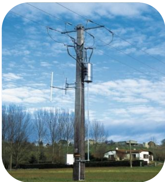
Ligne HTA 20 000 volts
