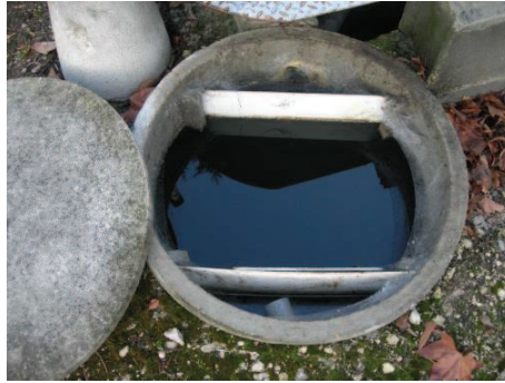
Bac à graisse reconverti en regard
