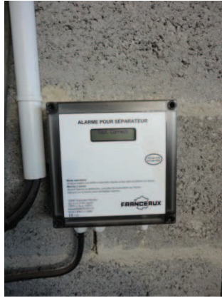
Boîtier alarme de séparateur
