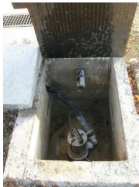
Pompe de relevage placée dans un regard
