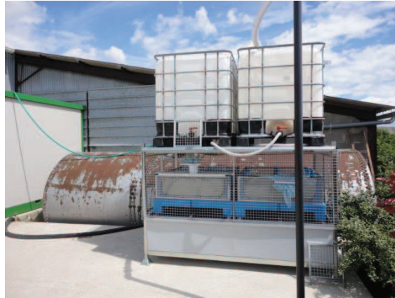
Station Osmofilm complète avec cuves de stockage et bac de rétention
