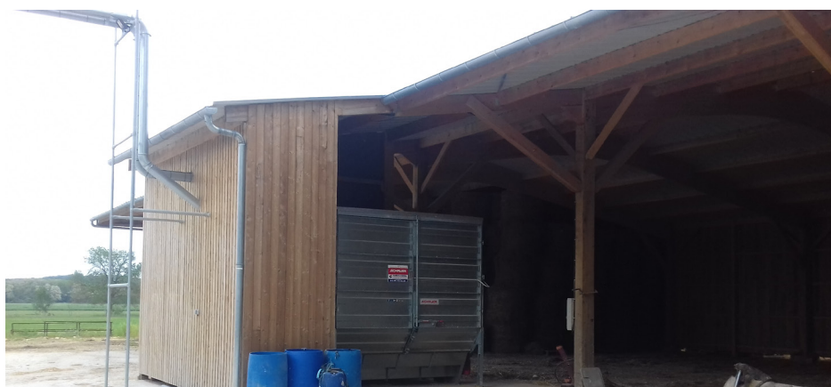
Vue d'ensemble démêleur-broyeur-aspirateur sous appentis
